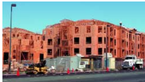
Los apartamentos de lujo Legacy Partners en construcción por la calle Galindo.
